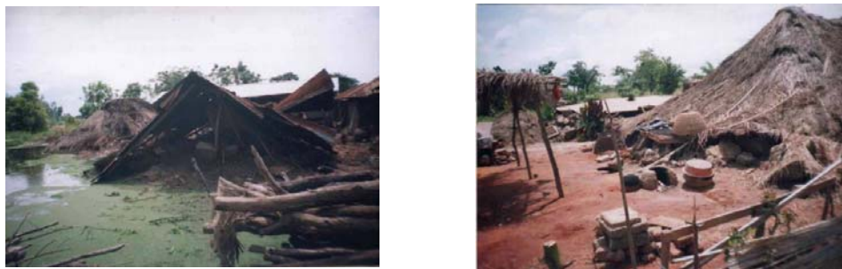
Photo 3. Habitation en matériaux locaux détruites à Kpoto-Zagnanado (Source : Cliché LECREDE , octobre 2003)
